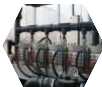
Planta piloto de electro-oxidación con ánodos de diamante
